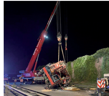
Der Verunfallte Autokran wird aufgerichtet
