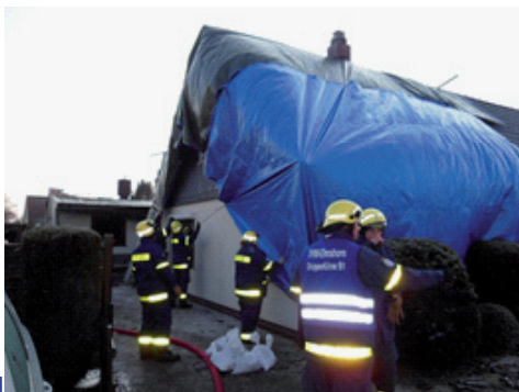
Dachsicherung nach Brand
